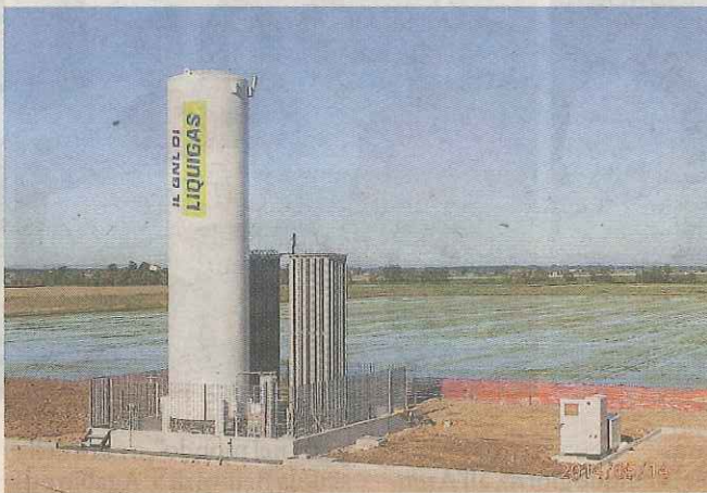
L'impianto realizzato nel sito produttivo novarese
